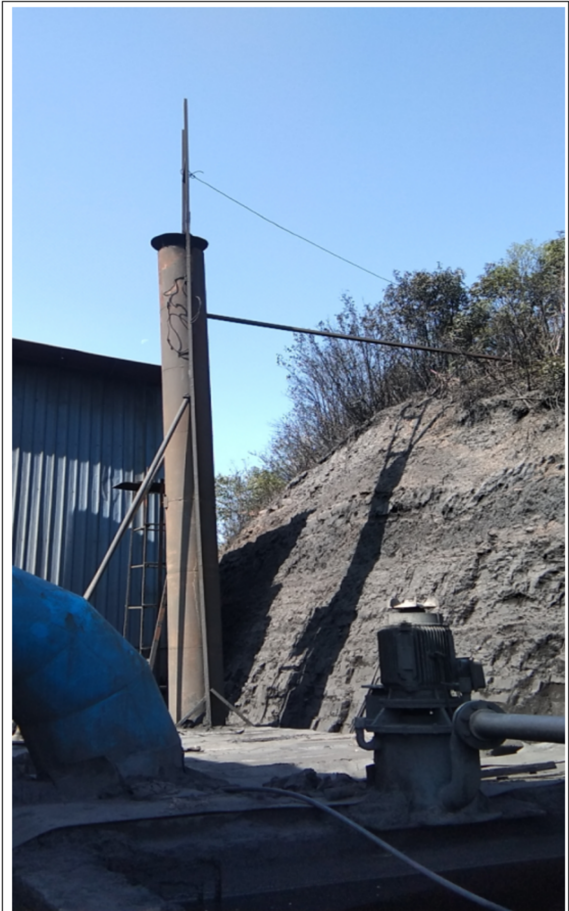
除尘器排气筒
